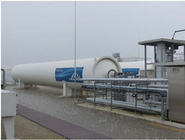
Energiepark Mainz, 12/2016 „Power to Gas“-Anlage (Elektrolyseur)
