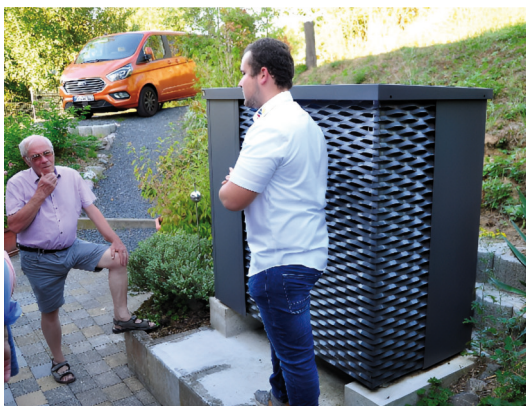
Hergersweiler, 08/2022 Wärmepumpe (Luft/Wasser)
