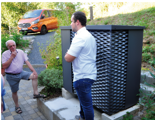
Hergersweiler, 08/2022 Wärmepumpe (Luft/Wasser)
