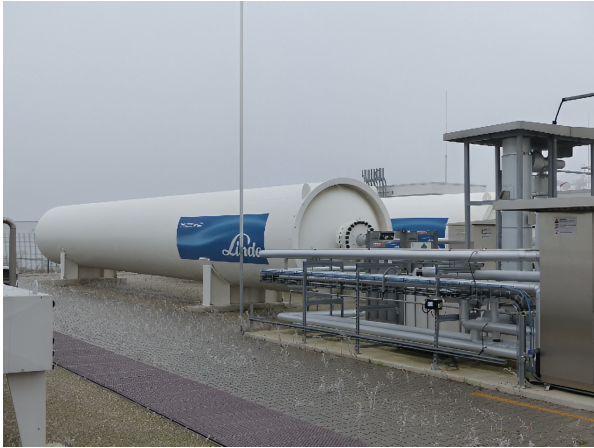
Energiepark Mainz, 12/2016 „Power to Gas“-Anlage (Elektrolyseur)
