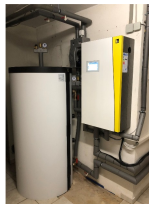
Pufferspeicher Heizung mit Hydraulik-Modul
