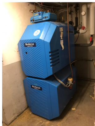
Ölkessel mit WW-Speicher
