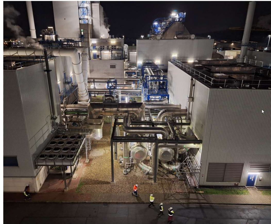
Gesamtsicht BeFI, WT3 und BMHKW
