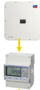
Erzeugungszähler für die PV Anlage
